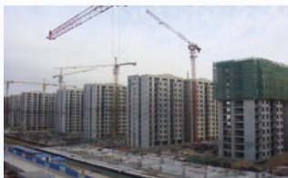
呼和浩特市新城區 「塞外安居新城」 公租房工程二期建設項目
